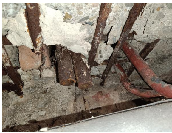
Fot.8 – Strefa przejścia instalacyjnego przez strop. Widoczne głębokie ubytki betonu odsłonięte i skorodowane zbrojenie.
