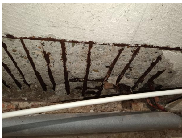
Fot.4 – Ubytek w strefie przypodporowej. Odspojona otulina betonowa, widoczna korozja zbrojenia.
