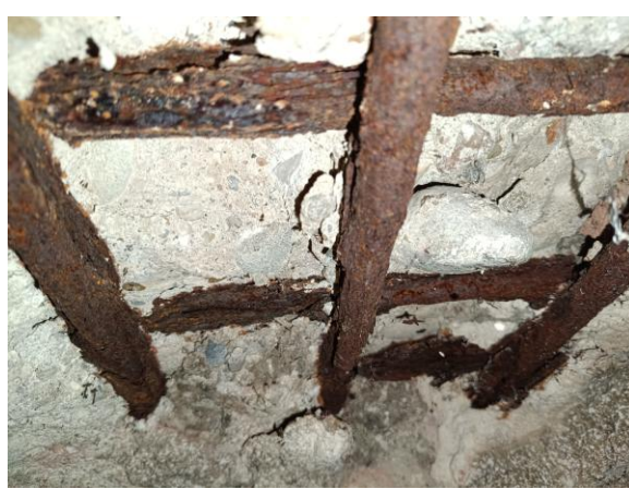
Fot.10 – Zbliżenie skorodowanego zbrojenia. Widoczne ubytki przekroju prętów oraz degradacja betonu. Otulina całkowicie odspojona, głębokie ubytki (do 60mm).
