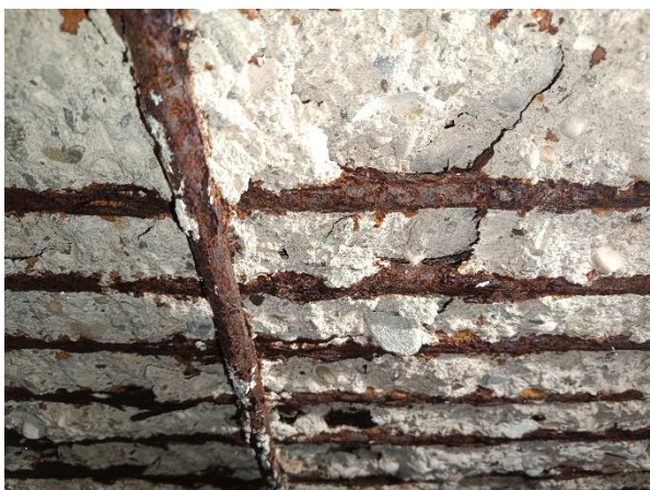
Fot.11 – Odspojona otulina betonowa z widoczną korozją zbrojenia. Ujawniony pręt, który najprawdopodobniej pełnił funkcję prowizorycznego dystansu pod zbrojenie.
