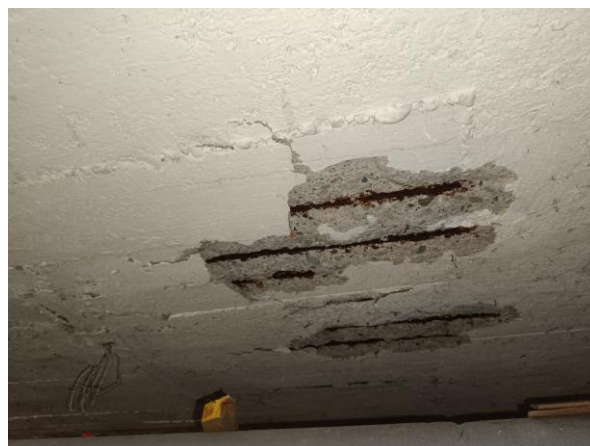
Fot.6 – Lokalny ubytek. Odspojona otulina betonowa z widoczną korozją zbrojenia. Obecne zarysowanie betonu oraz większy fragment otuliny, który mimo uszkodzeń wciąż pozostaje połączony ze stropem
