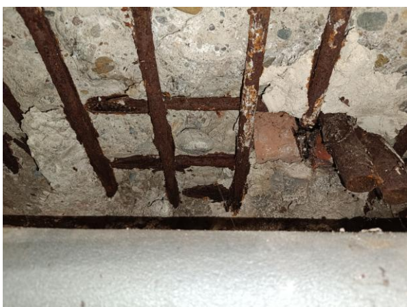
Fot.9 – Widoczne odsłonięte zbrojenie (oba kierunki) w strefie podparcia. Zaawansowana korozja, miejscowo przekroczona głębokość otuliny.
