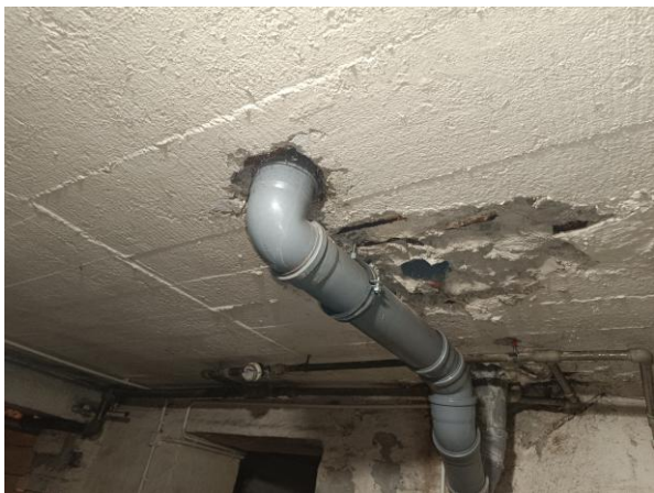
Fot.7 – Strefa przejścia instalacyjnego przez strop. Widoczne rozległe odspojenie otuliny betonowej wokół rury oraz uszkodzenia powierzchni betonu z odsłoniętym i miejscowo skorodowanym zbrojeniem.
