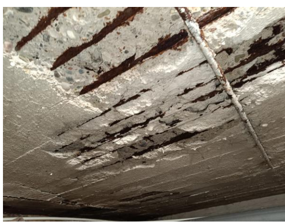
Fot.12 – Odspojona otulina betonowa z widoczną korozją zbrojenia. Ujawniony pręt, który najprawdopodobniej pełnił funkcję prowizorycznego dystansu pod zbrojenie.
