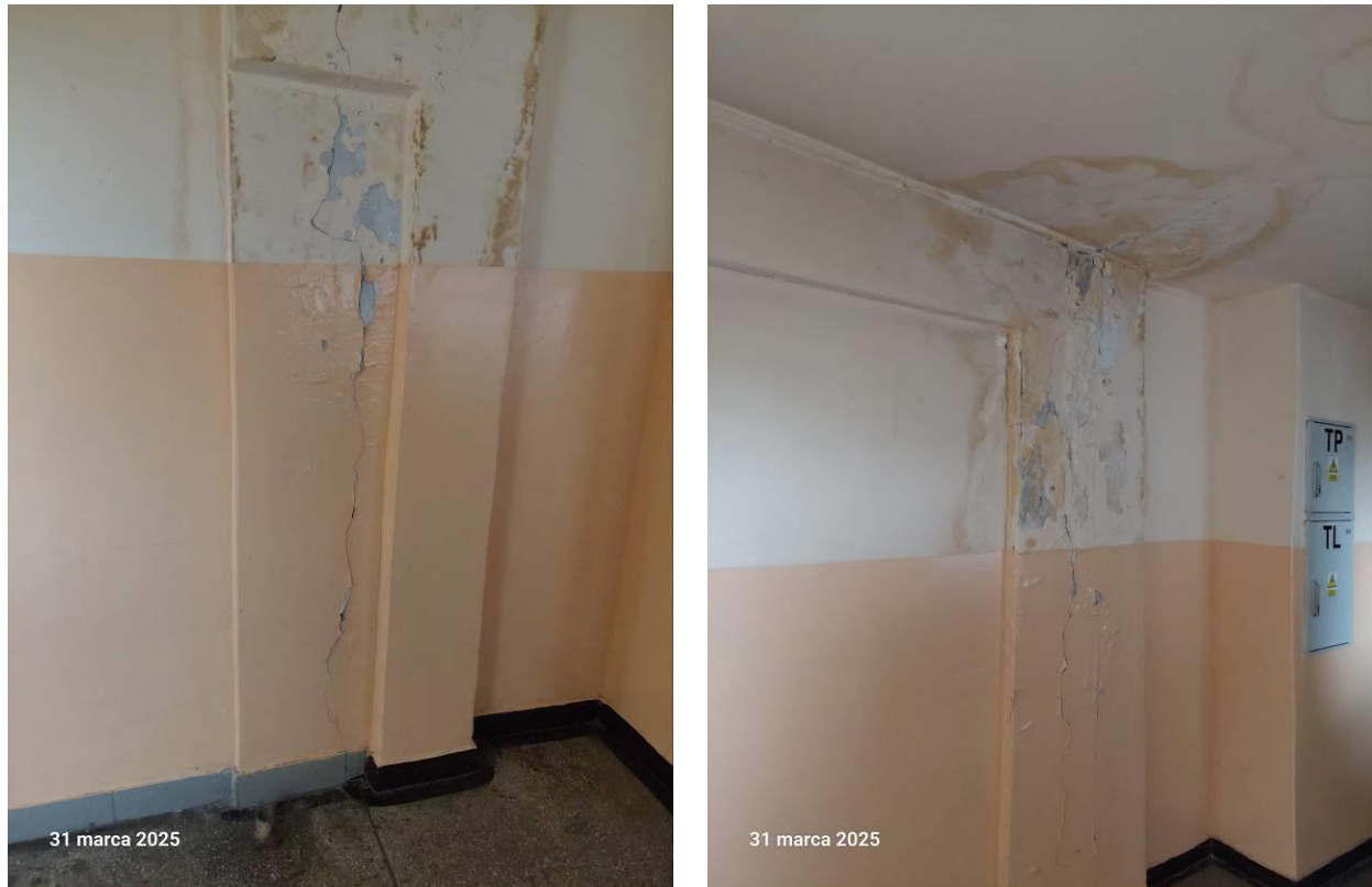
Rys. 10. Zacieki i odparzenia tynków na III i IV piętrze
