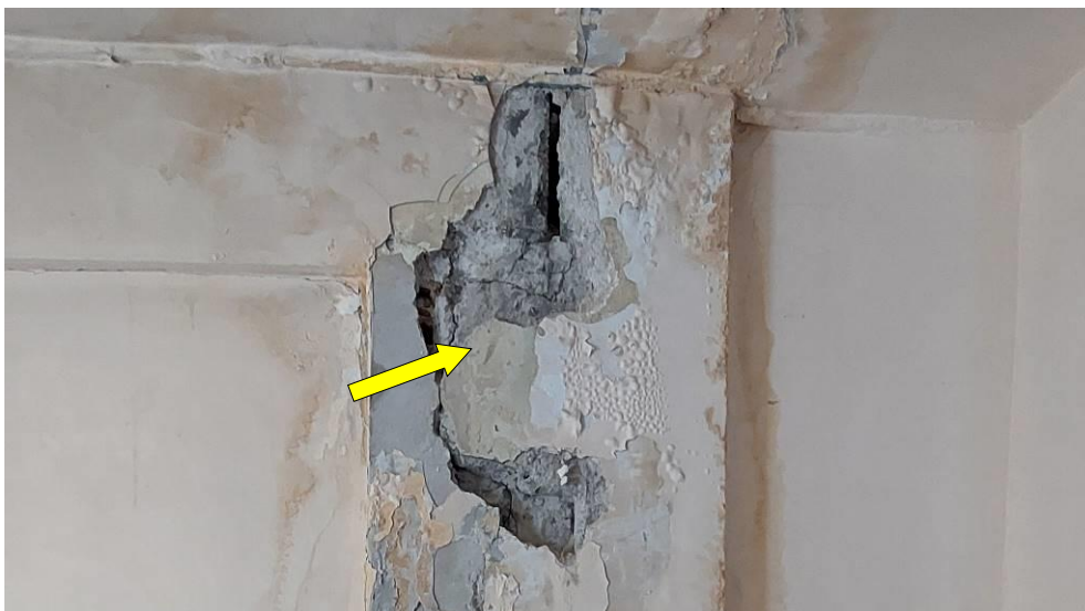
Rys. 12. Mierny stan żelbetowego wspornika na IV piętrze
