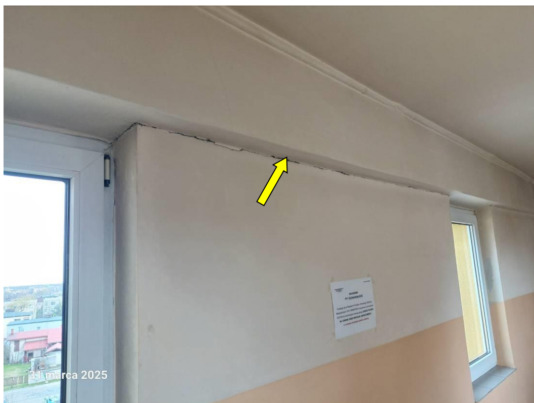
Rys. 9. Rysa pozioma na ścianie łącznika pod belką (IV piętro)
