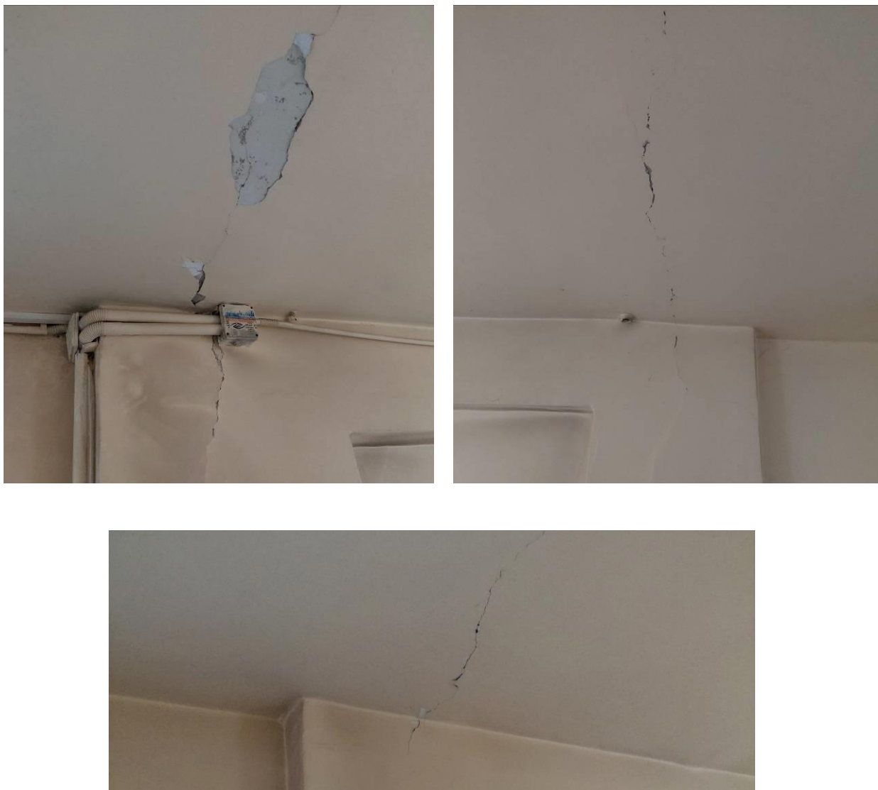
Rys. 5. Rysy na tynkach sufitowych
