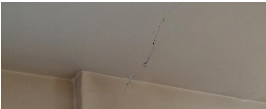
Rys. 5. Rysy na tynkach sufitowych
