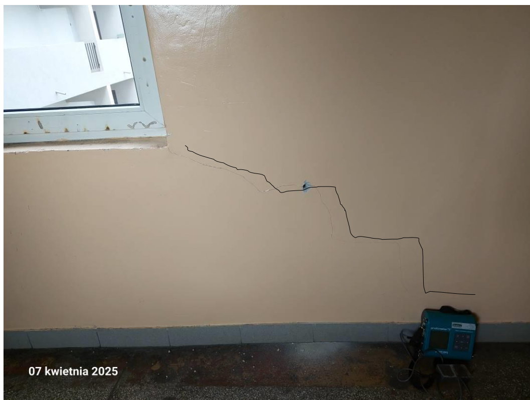
Rys. 8. Rysy poziome i ukośne na ścianach łącznika
