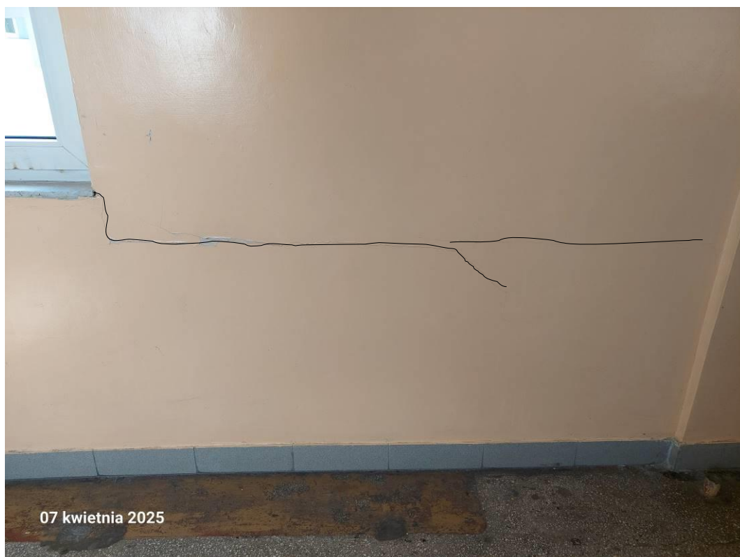
Rys. 7. Rysy poziome i ukośne na ścianach łącznika
