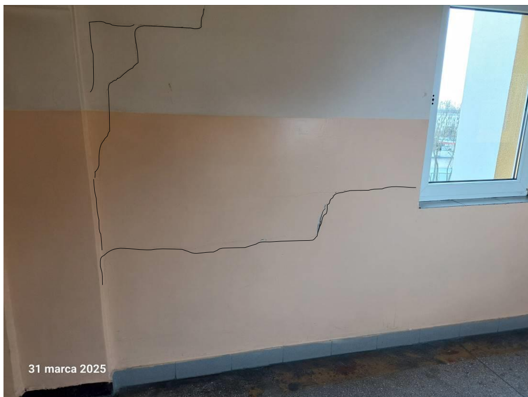
Rys. 6. Rysy na ścianie łącznika (IV piętro)
